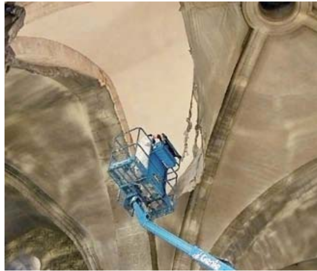
フランスの教会でSRFを剥がしている例
